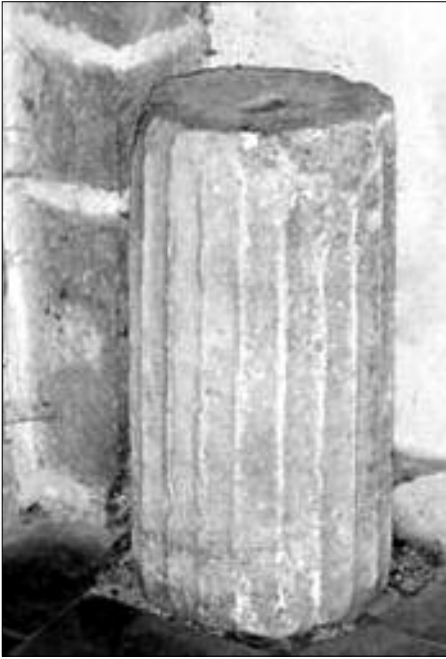
22. Pereto , santuario Madonna dei Bisognosi, aula quadrata vicino l'uscita posteriore. Rocchio scanalato, rastremato (?), incisione rettangolare di ancoraggi. No misure.
