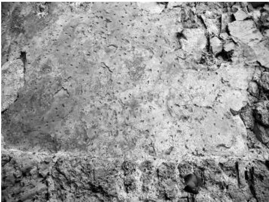
Fig. 2. Monastero di San Giorgio, Riofreddo, lacerti di intonaco dipinto sulla parete dell'interno della chiesa, in direzione del campanile (Foto: Federico Ramadori 2023)
