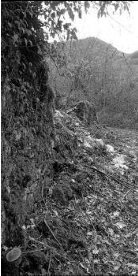
Riofreddo (RM). Resti della chiesa di S. Maria Maddalena, parete nord, parte crollata
